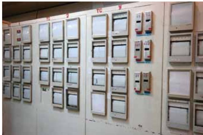
Широко известные приборы серии КС на щите управления паровым котлом
